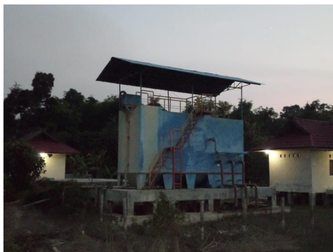
Gambar 7. Unit pengolah air minum di Desa Petak Bahandang
